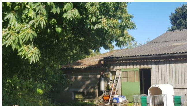
Figure 25 : Photo de dégâts occasionnés sur un toit par des branches tombées de la haie (réalisation personnelle).
