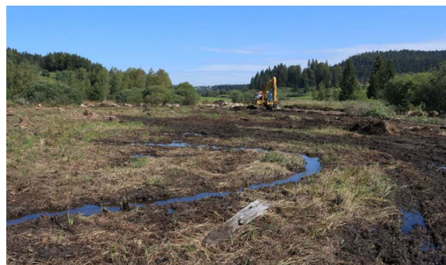
Photo 21 - Travaux de restauration du fonctionnement hydrologique du marais du Châtelet (Saint-Laurent-en-Grandvaux, 39). Le reméandrement de la Lemme permet d'améliorer l'alimentation en eau de cette tourbière (© F. Muller)
